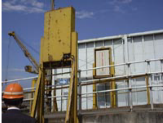
写真 8.1 ゲートモニタの例
